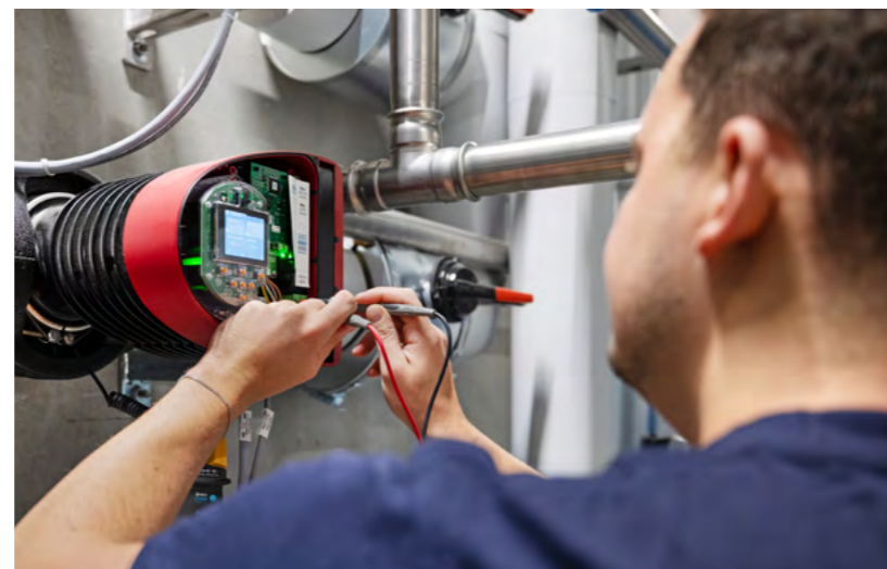
Dominik Gruber, Inbetriebnahmetechniker bei Hörburger, überprüft noch einmal die korrekte Funktion einzelner Komponenten
